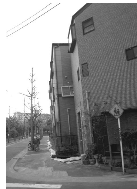
北側が沈んで傾いた一戸建て
